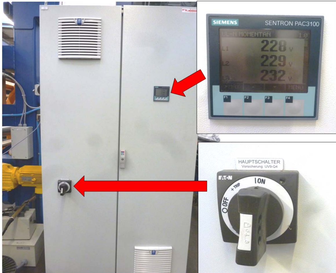
Hauptschalter und Display zur Anzeige der Verbrauchswerte der Anlage am Schaltschrank.
